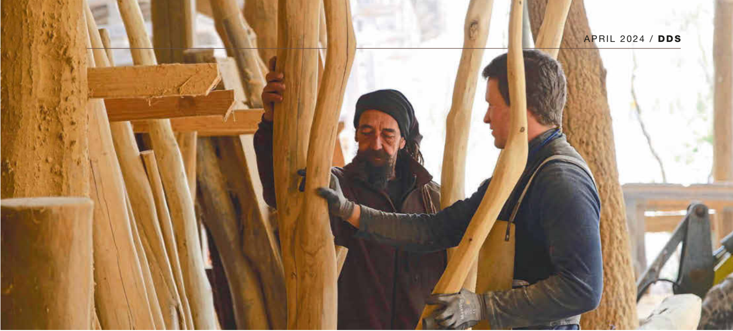
Holger Schwarz (links) und Zimmerermeister Moritz Bukovski auf der Suche nach Pfosten für die Reling
